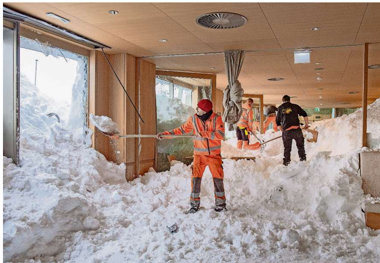
Das erste schwere Unglück dieses Winters am Säntis: Das Hotel Schwägalp wurde von einer Lawine teilweise verschüttet.
